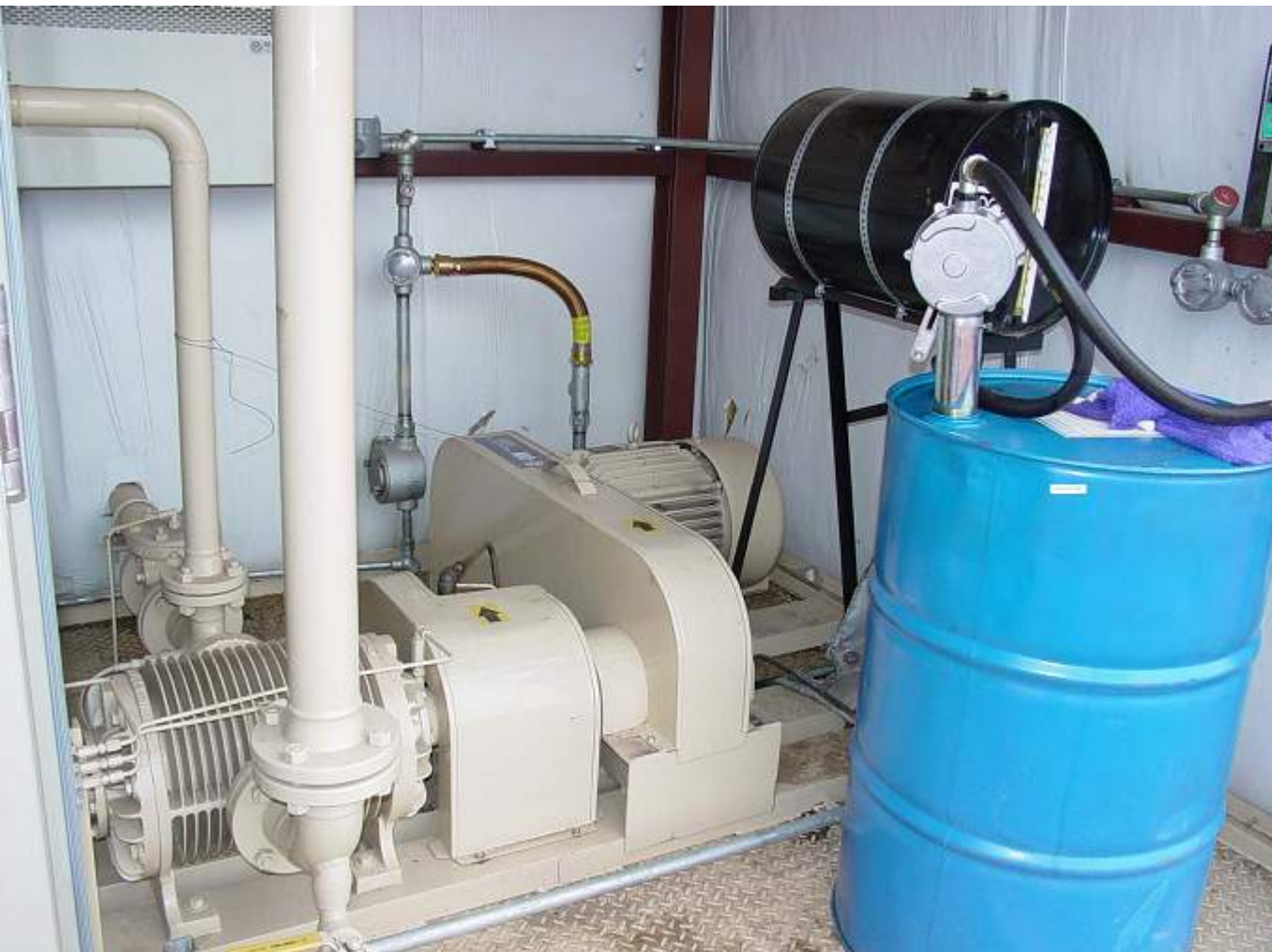
Вакер, Монтана, СопосоPhillips – Установка сбора паров;
